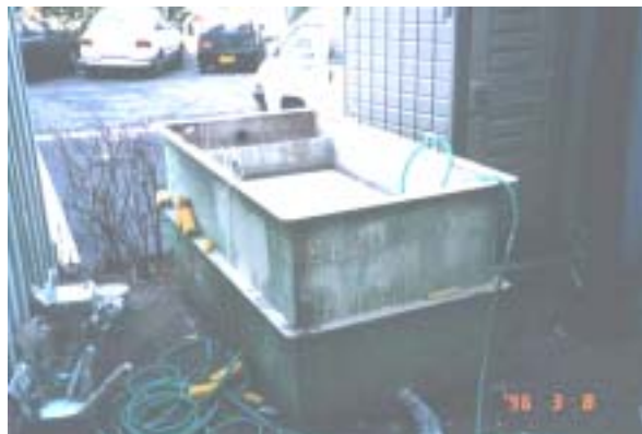
廃液濾過装置 (ノッチタンク)
